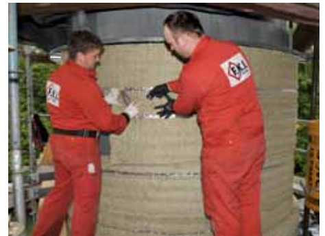
Bei der Montage konnte Arbeitszeit eingespart werden – denn statt bisher geplanter 3-lagiger Verlegung beim Dampfspeicher konnte mit U Tech Wired Mat 5.0 auf eine Lage verzichtet werden.
